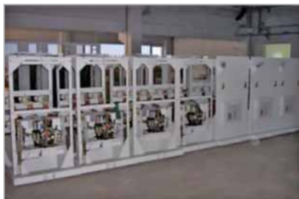
Postrojenja 6 kV bloka 5 u fazi retrofita
