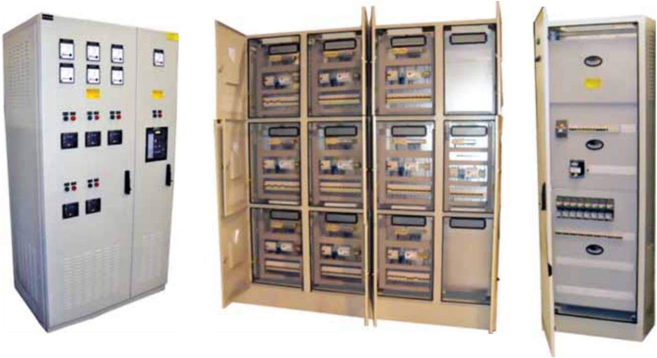
Razvodni ormari za namjene glavne distribucije, IT sistema, sekundarne distribucije, ...
