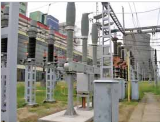
Novo 110kV rasklopno postrojenje "TE Tuzla"
