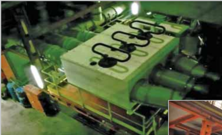
Ugradnja generatorskog prekidača (AREVA) 8500A, 15kV i rekonstrukcija sabirnica na Bloka 5 u "TE Kakanj"
