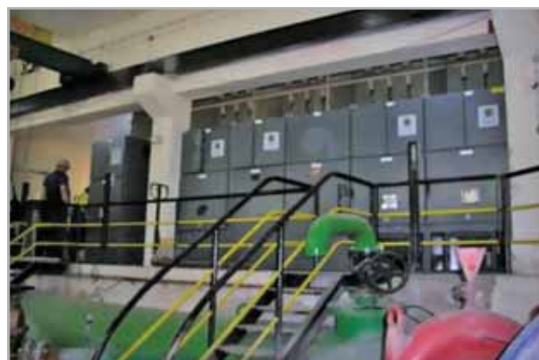
"Pumpna stanica MODRAC" 6 kV postrojenje nakon retrofita
