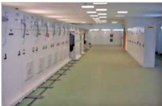
Postrojenja 6 kV bloka 5 nakon retrofita
