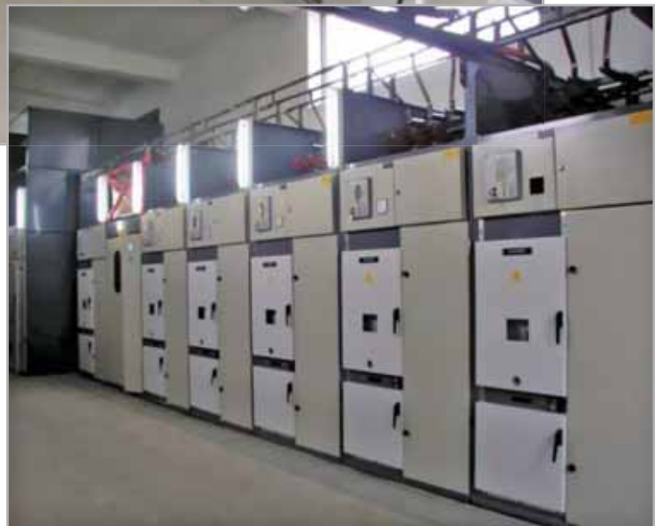
Postrojenje nakon retrofita
