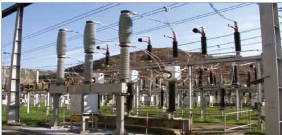
Rekonstrukcija rasklopnog postrojenja 110 kV, "TE Tuzla"
