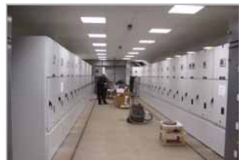
Postrojenje nakon retrofita
