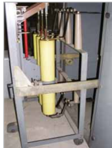
Fiksni prekidač na izvlačivim kolicima
