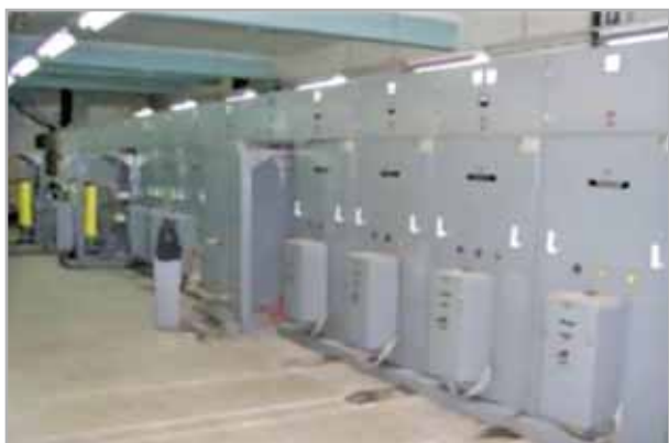
Postrojenja 6 kV bloka 5 prije retrofita
