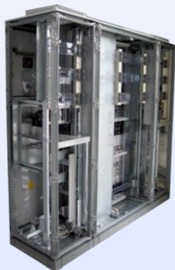
Proizvodnja i asembliranje NN ormara za distribuciju prema TTA Ugovoru: DELING - ABB Sriebeel & John Germany
