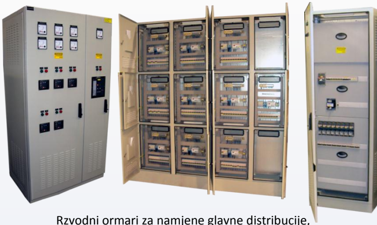
Razvodni ormari za namjene glavne distribucije, IT sistema, sekundarne distribucije, ...
