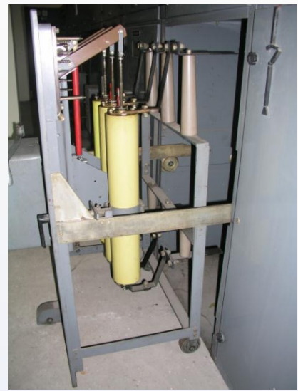
Fiksni prekidač na izvlačivim kolicima
