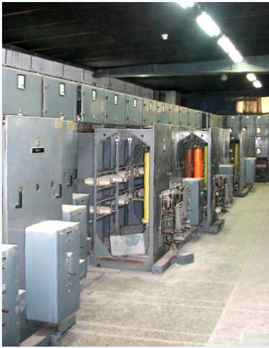
Postojeće postrojenje sa fiksnim malouljnim prekidačima
