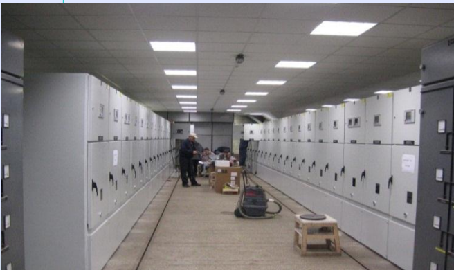
Postrojenje nakon retrofita
